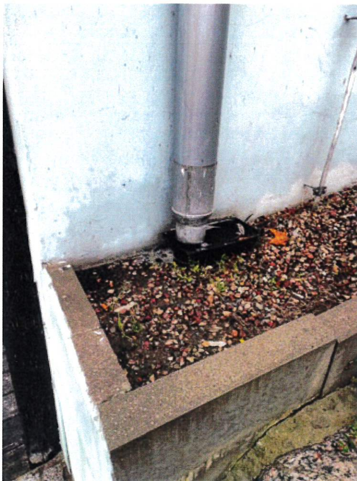
Fot. nr 15 Nieskuteczne odprowadzenie wody z rury spustowej Południowo-zachodni narożnik budynku
