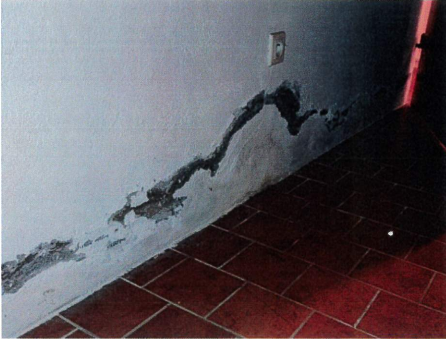
Fot. nr 12 Korytarz (0/1) Zawilgocenia ściany wewnętrznej w pasie przyposadzkowym.
