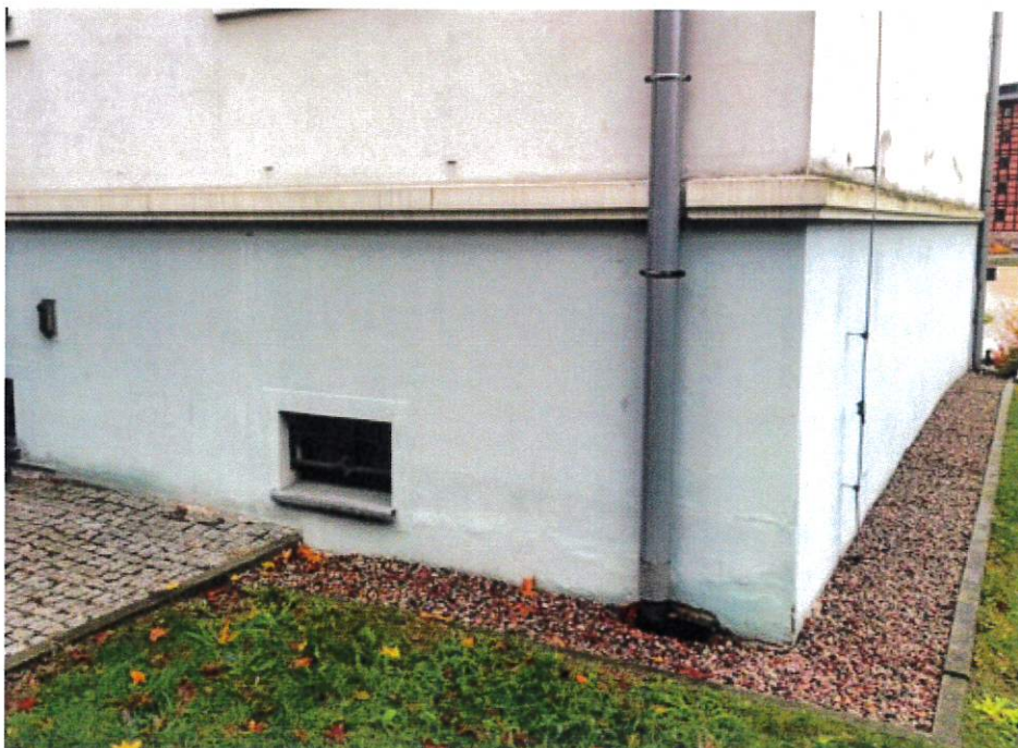
Fot. nr 6 Wschodnio-północny narożnik budynku Widoczne zawilgocenia i uszkodzenia tynku w dolnej części ściany
