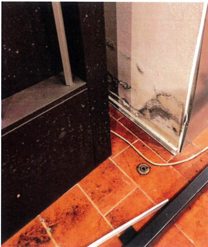
Fot. nr 9 Pomieszczenie nr 0/2. Zawilgocenia w dolnej części filarka Naloty grzybów pleśniowych widoczne na posadzce oraz na gablocie
