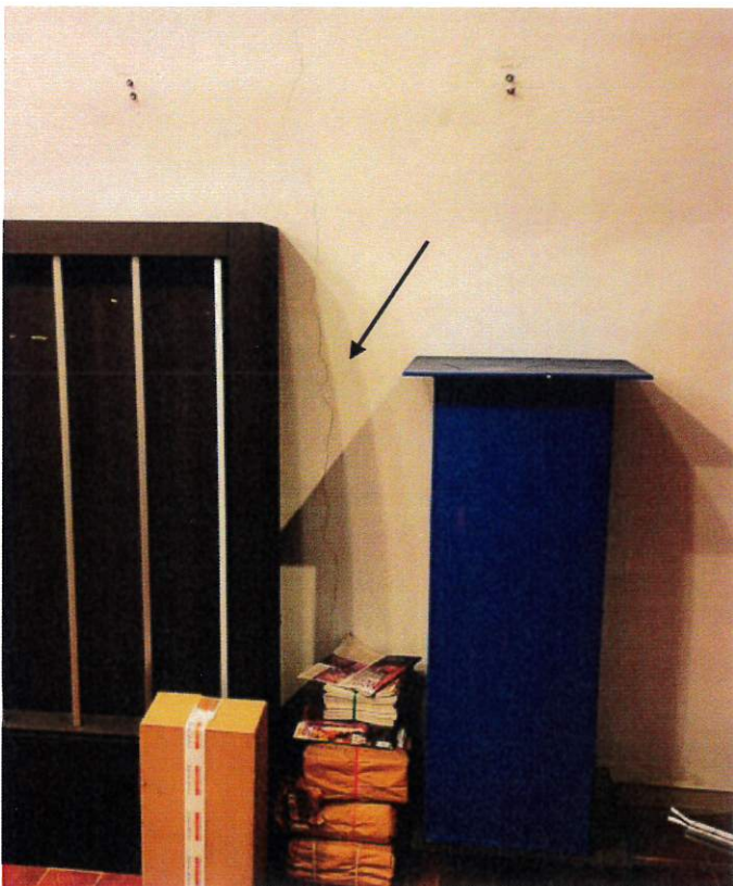
Fot. nr 10 Pomieszczenie nr 0/2. Zarysowanie na ścianie zewnętrznej południowej
