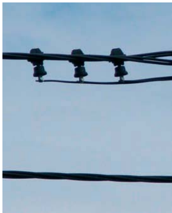
linia główna 1 komplet ASA co 500 m
