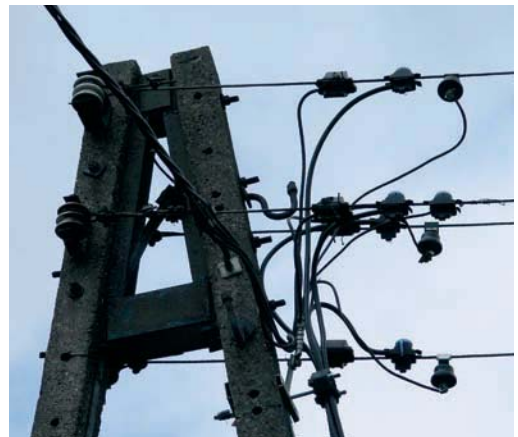
koniec linii napowietrznej nn
