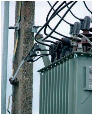
początek linii napowietrznej nn
