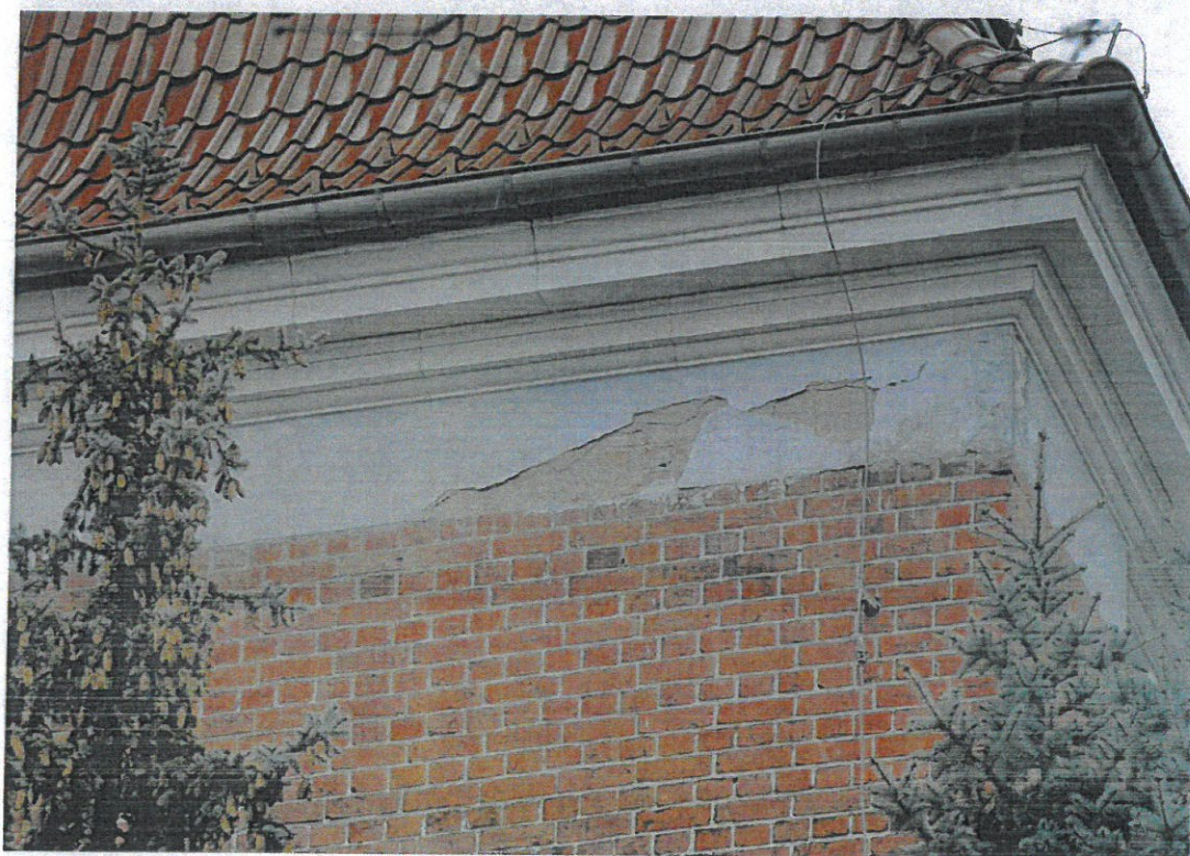
Widok czarnych nawarstwień na cokole oraz odpadające tynki we fryzie.
