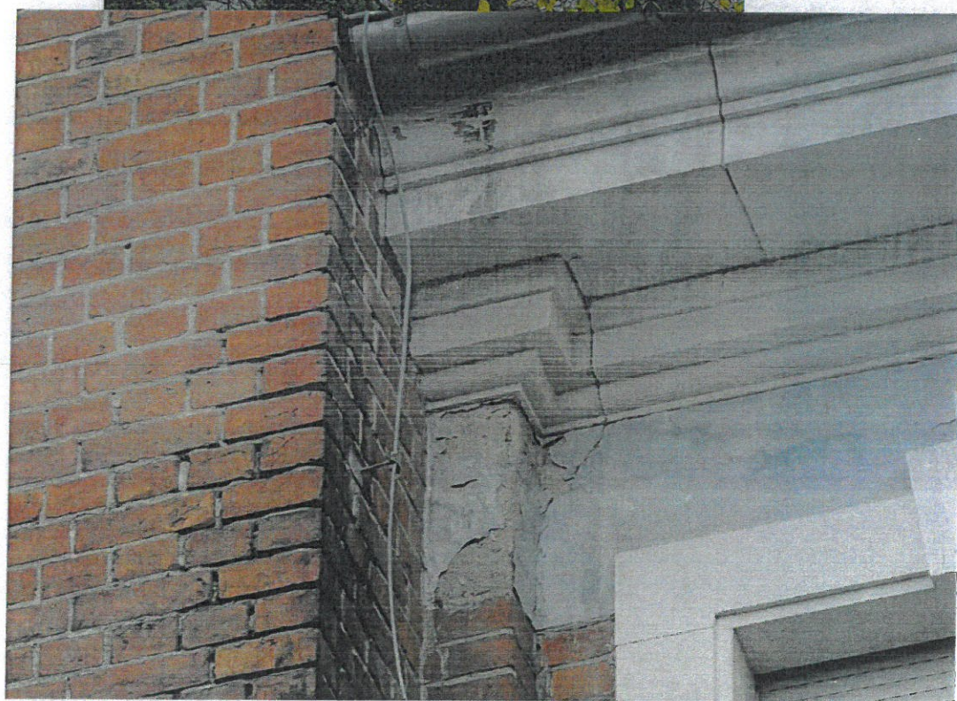
Widok odpadających tynków, zawilgocenia i czarnych zacieków
