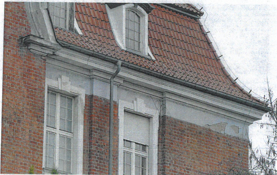
Fragment, na którym widać złuszczenia farby na piaskowcu opaski okiennej oraz odpadające tynki
