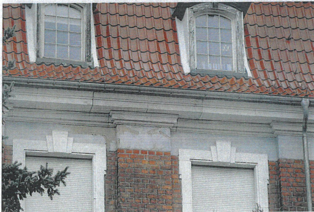
Widok odpadających tynków
