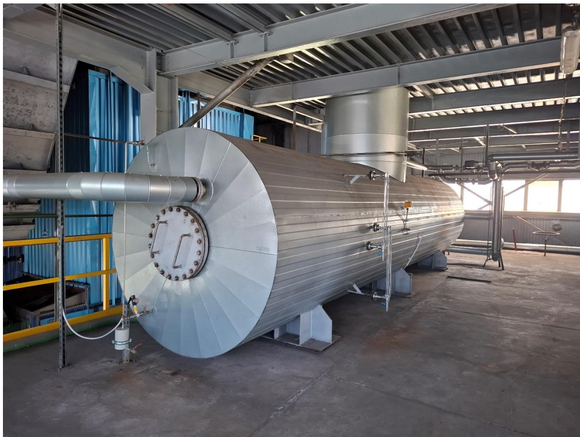
Fot. 1. Pierwszy zbiornik wody zapasowej (odgazowanej) – widok 1
