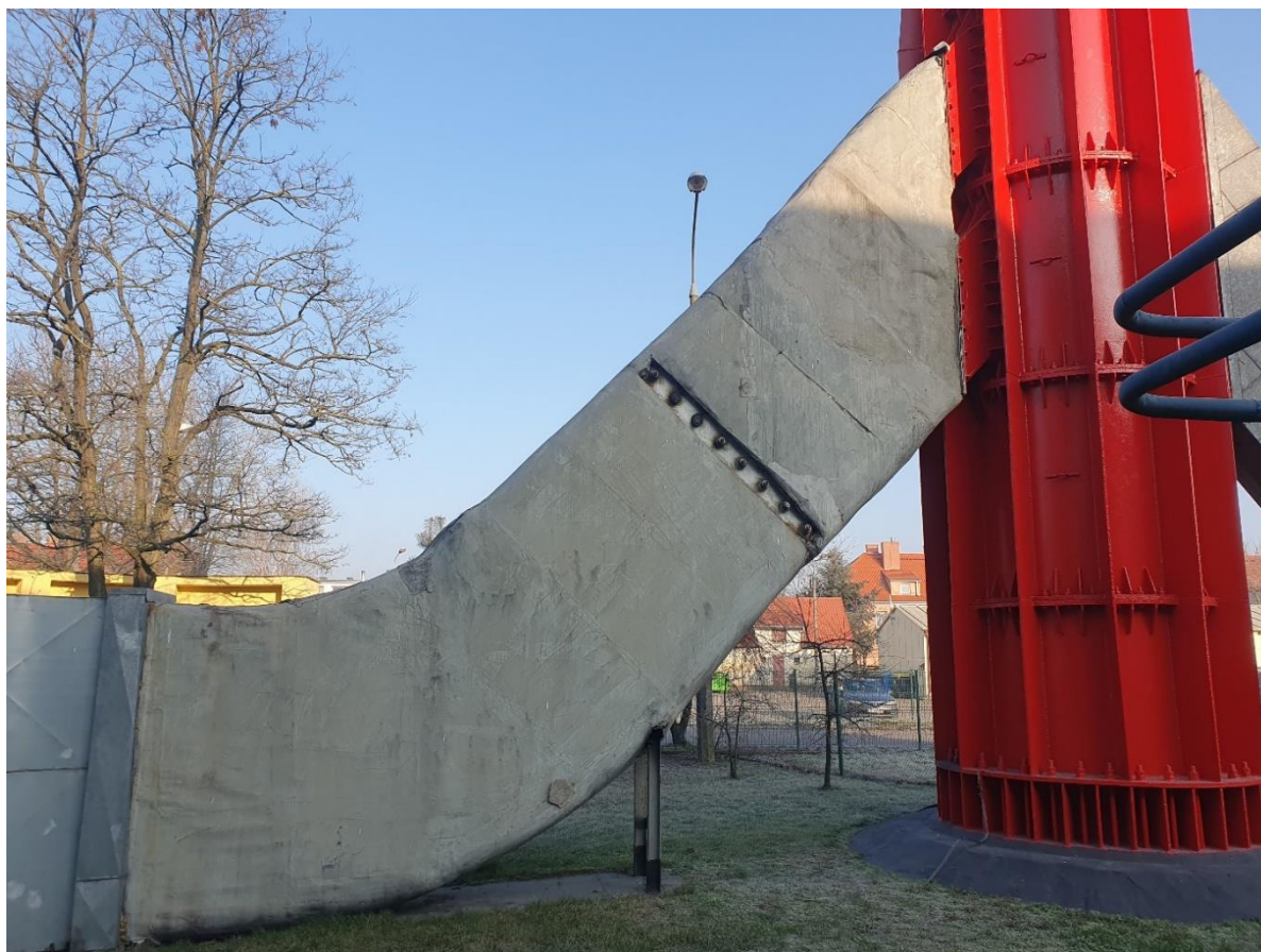
Fot. 1. Odcinek kanału przeznaczony do wymiany na nowy
